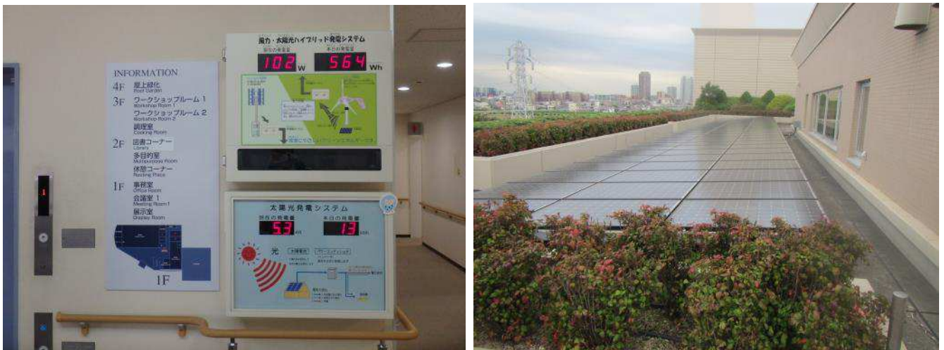
図 8-11 太陽光パネルの設置の例
